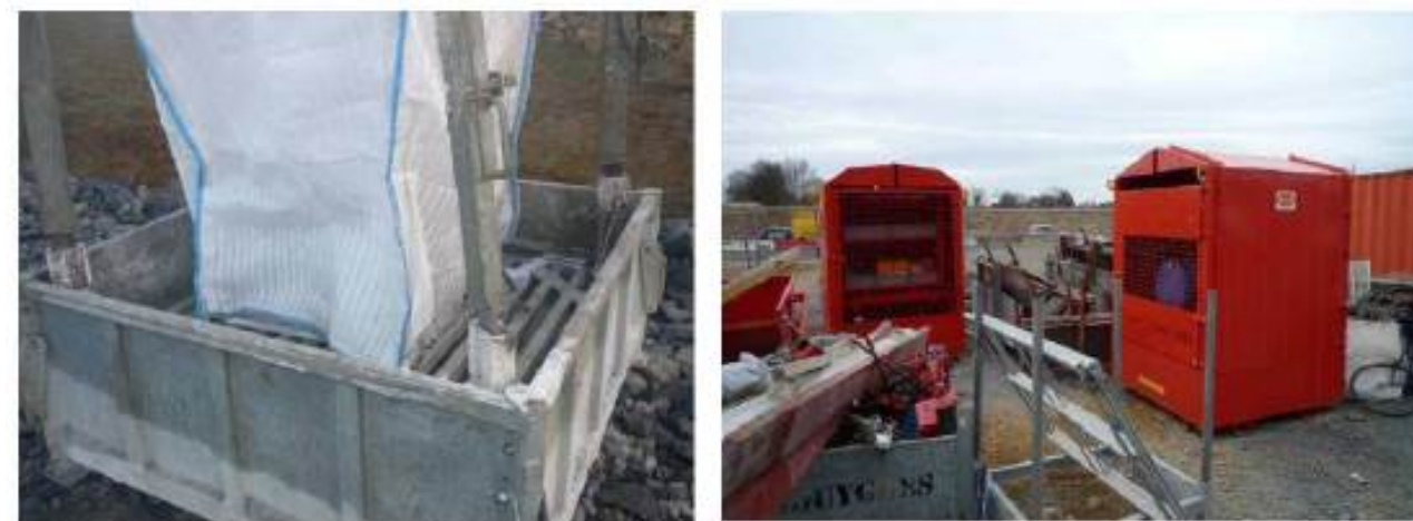
Figure 70 : Système de lavage des goulottes des toupies béton dans un big-bag (à gauche) et système de stockage de produits polluants (à droite) - Source Egis
