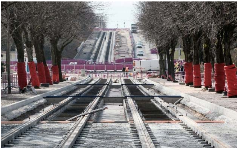
Figure 63 : Travaux de construction de la plateforme du Tramway – Dijon (Source Egis Rail : dossier d'étude d'impact TGO1)
